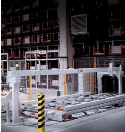
UNICOMPACT chez un fabricant de profilés en PVC.
