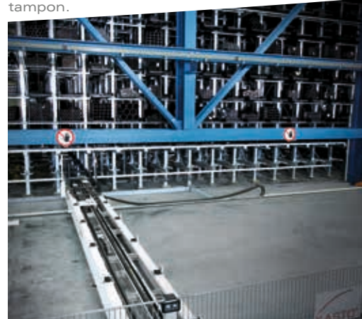
Station tampon sur le côté longitudinal du magasin avec 14 emplacements tampon.
