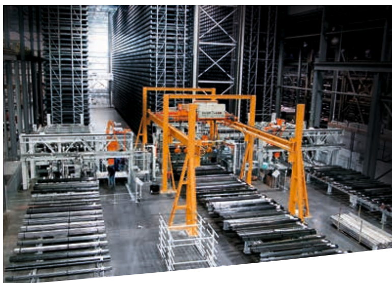
UNICOMPACT avec trois blocs de rayonnage et deux transstockeurs.
