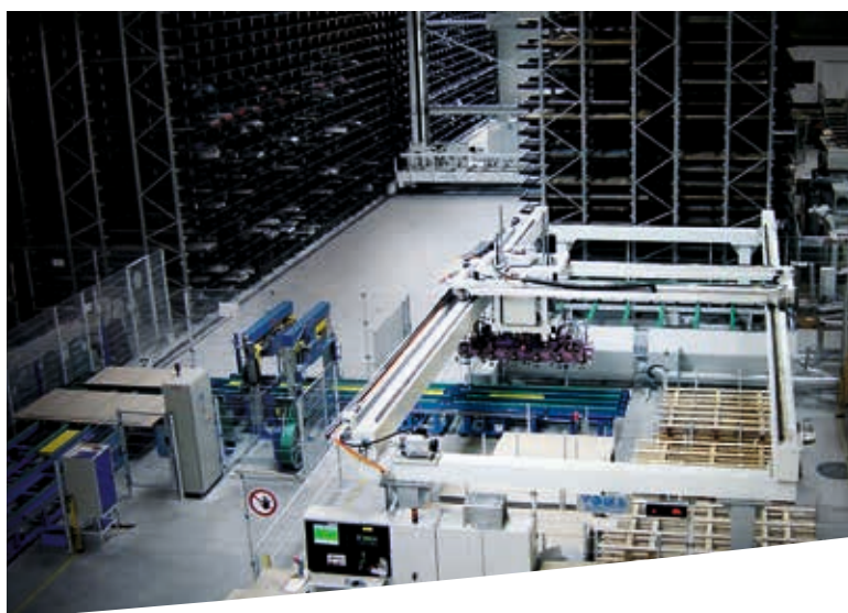
Magasin en nid d'abeilles pour produits longs/tôles avec installation de préparations de commandes pour tôles entièrement automatique.
